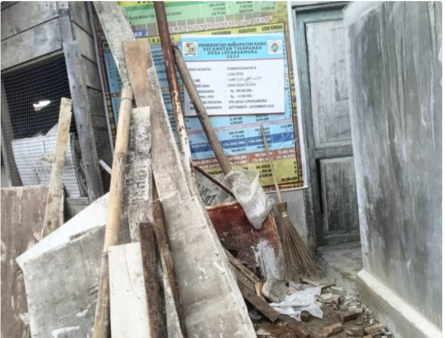
Potret Bangunan Fasilitas MCK Desa Lepar Samura yang Telan Dana Ratusan Juta
